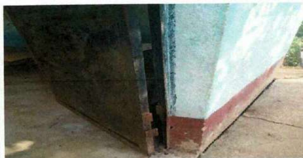
Foto 4: Se puede observar el deterioro una de las puertas de las aulas.
