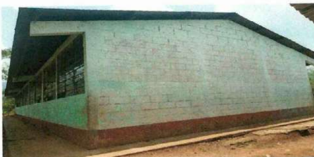
Foto 3: Se puede observar el desprendimiento de pintura .
